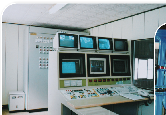
操作監控中心
